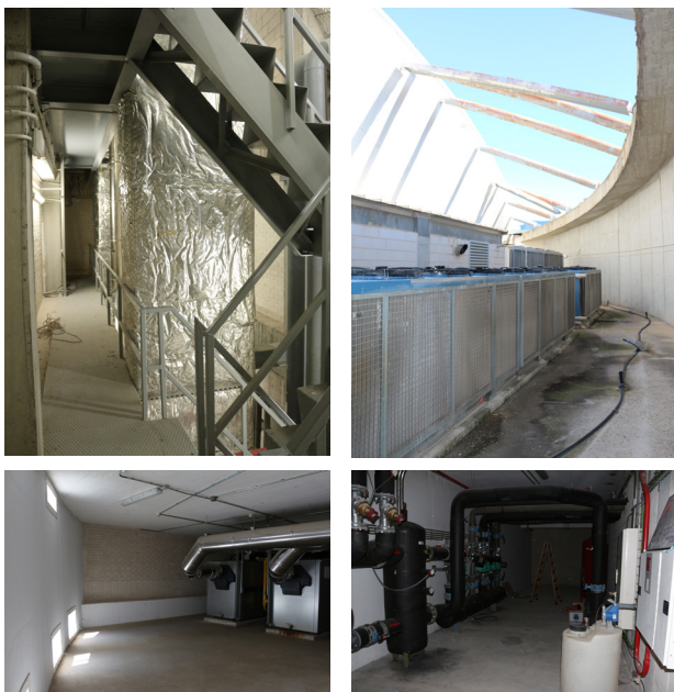
48. Salas de instalaciones correspondientes a los números 7, 11 y 8.
