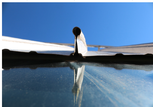
41. Detalle panel de aluminio tipo Kalzip, unión sistema de clips con RPT.
