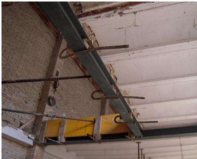
Figura 8: Apertura de hueco en un forjado existente para generar una doble altura en el proyecto.
