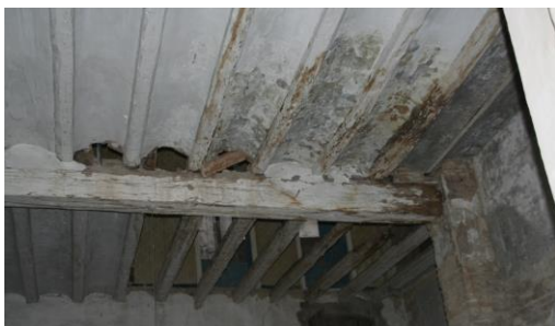
Figura 7: Fotografía en la que se muestra una degradación parcial del forjado visto desde su cara inferior.
