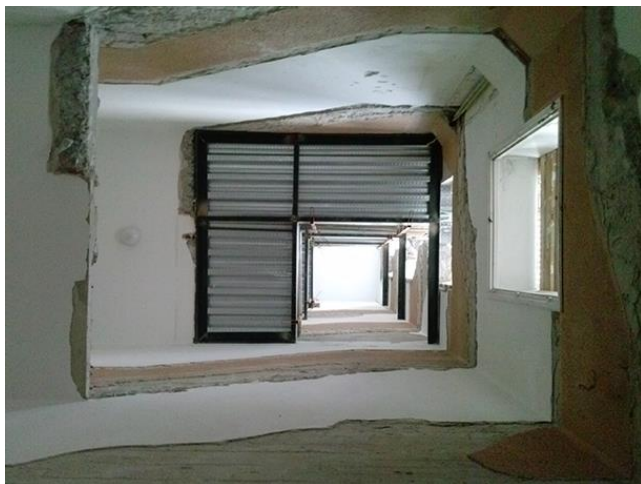
Figura 9: Realización de hueco de ascensor a partir de la demolición de un tramo existente.
