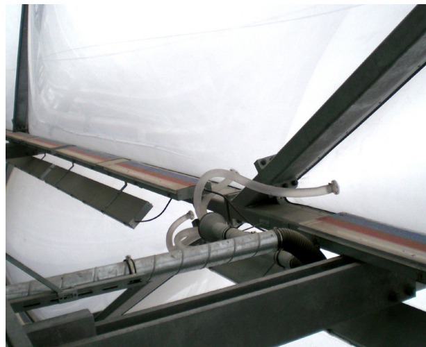
[5.26] Vista interior de la almohadilla hinchable de ETFE, el sistema de iluminación y el de aire comprimido.
