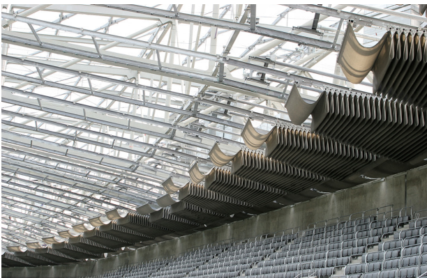
[5.29] Vista interior de la cubierta de toldos retráctiles en el estadio Allianz Arena. Múnich, 2005.
