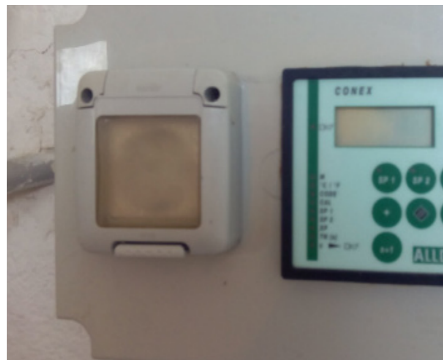
Fotografía propia. Máquina de control de Cloro que nunca ha funcionado.
