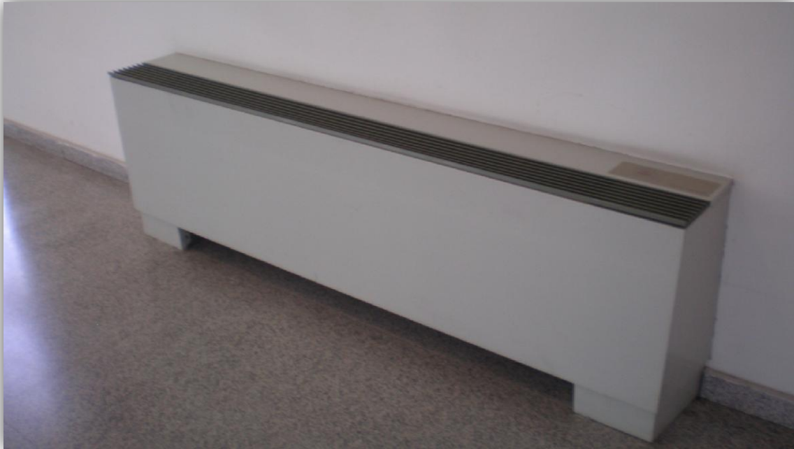
Figura 3.5. Fotografía de un fan coil del edificio
