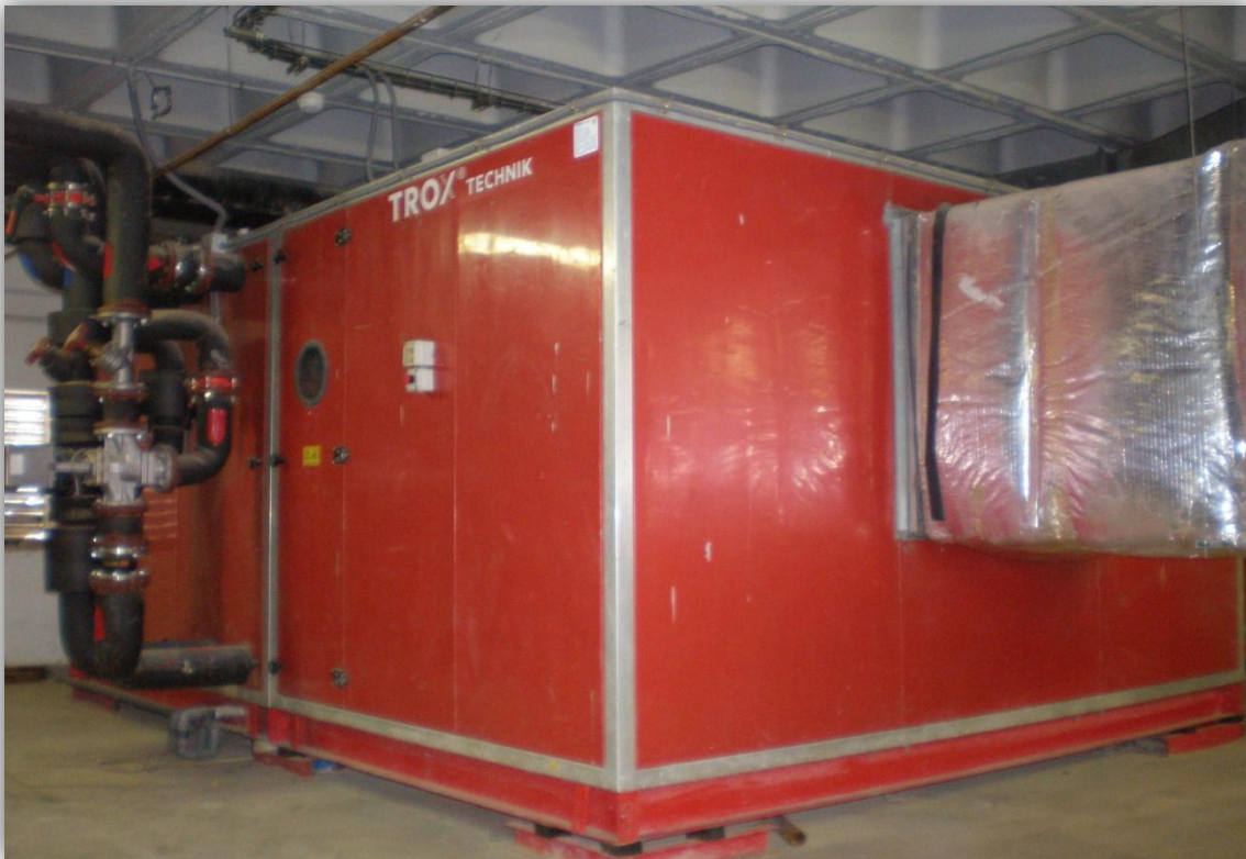
Figura 3.4. Fotografía del climatizador de la biblioteca
