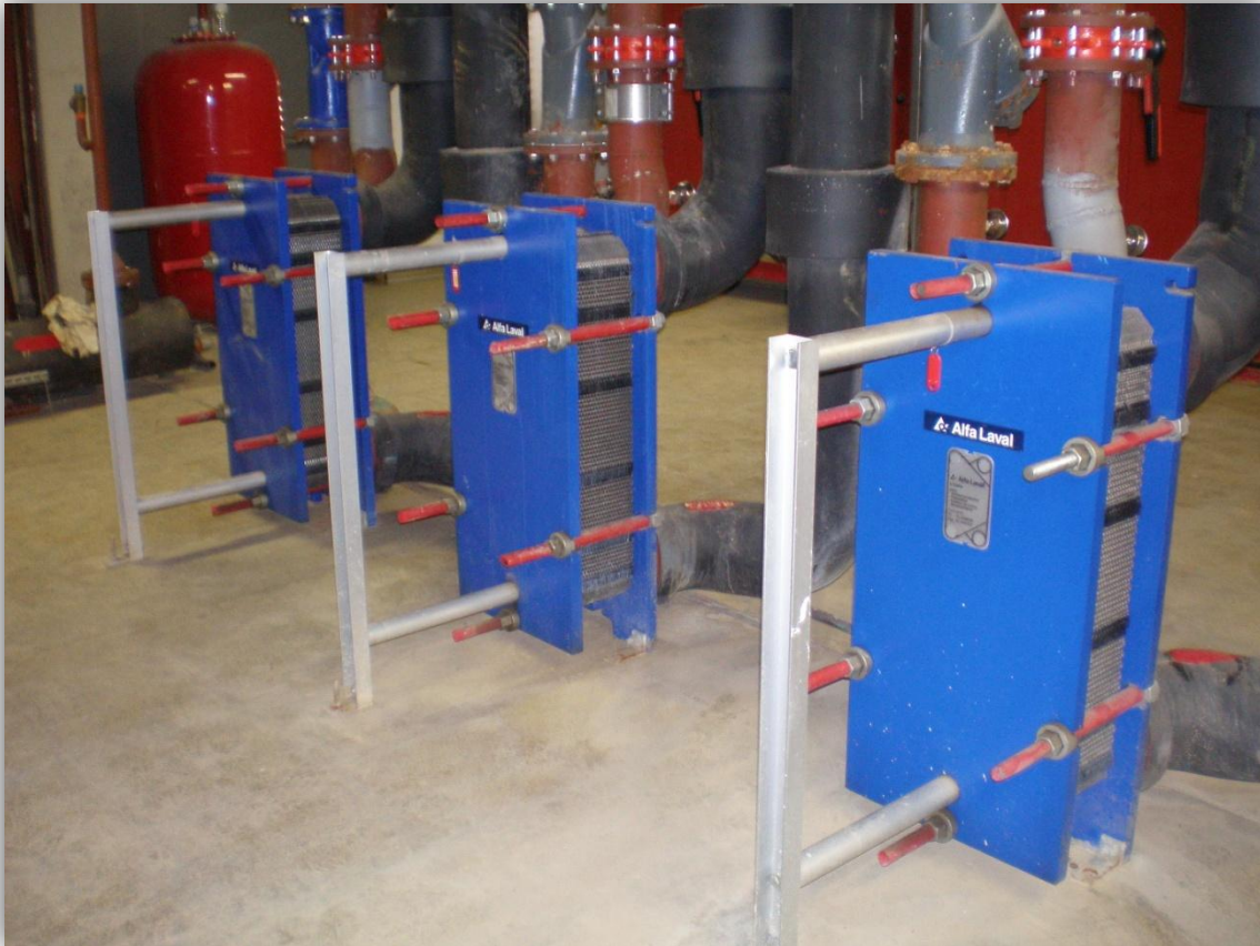
Figura 3.2. Fotografía de los intercambiadores de placas
