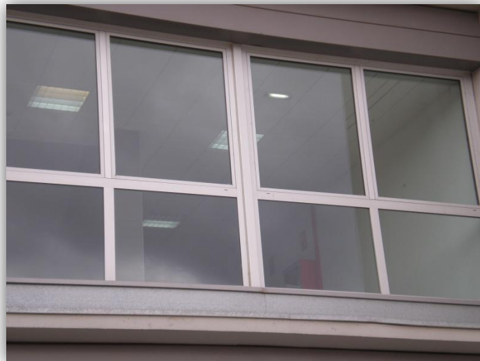
Figura 2.7. Fotografía de una ventana sin lamas en la zona Norte del edificio
