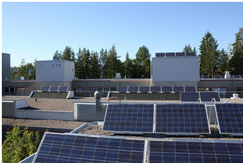
Figura 3.1. Parte de la instalación fotovoltaica de la TUT.
