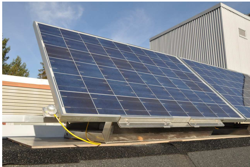
Figura 4.1. Piranómetro SP Lite 2 montado próximo a un string fotovoltaico.
