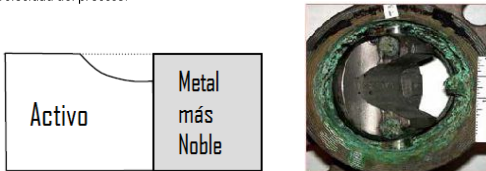
Figura 3.3 Representación de corrosión galvánica. Ejemplo de dos piezas metálicas en una válvula tipo mariposa, se observa la corrosión del anillo de bronce respecto el disco de titanio.
