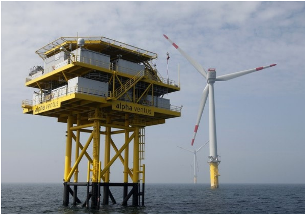
Ilustración 20 Subestación eléctrica (Revista eólica y del vehículo eléctrico, n.d.)
