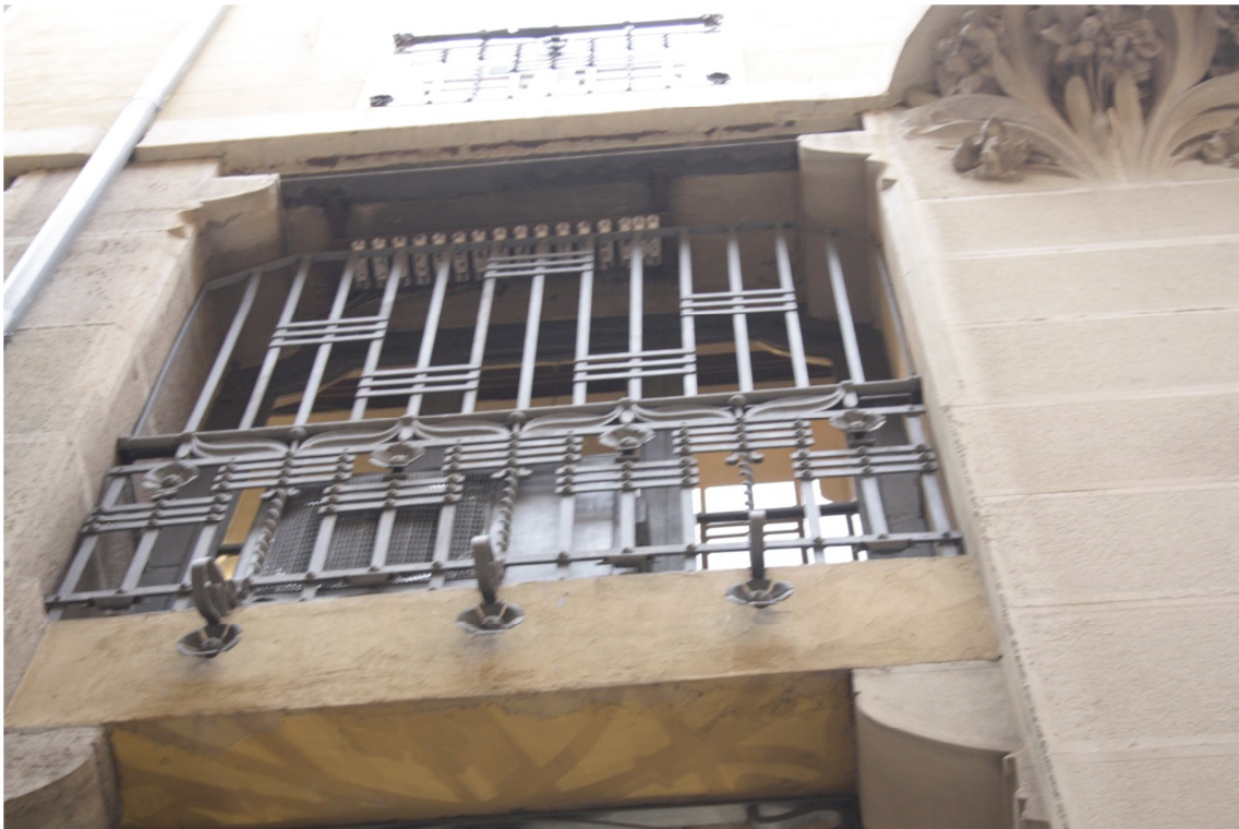
Figura 26. Detalle de los vanos de la fachada de la calle Pozo de la Casa Ferrán (Fotografía: autora).
