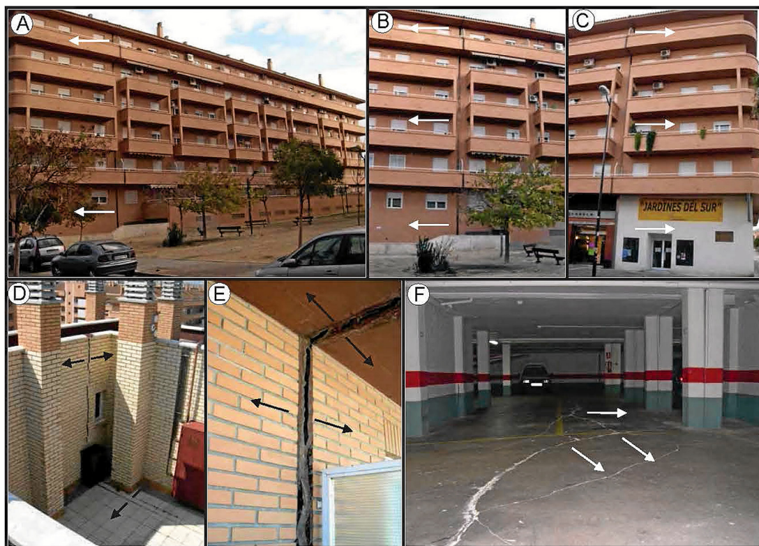
Fig. 9. Fotografías del edificio que presenta movimientos de basculamiento lateral localizado en las proximidades de la dolina analizada en la figura 8. (A, B, C) Vista general del edificio en el que se identifica la apertura de las juntas de dilatación (se incluyen flechas con los movimientos relativos de desplazamiento identificados). D y E) Detalle de las juntas de dilatación del edificio con indicación del movimiento de apertura relativo. F) Fotografía de las grietas en el garaje de la edificación con indicación del sentido de movimiento identificado.
