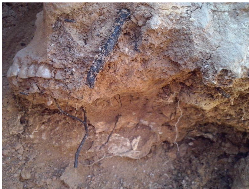
Figura 48. Acción destructora de las raíces. Foto EGF
