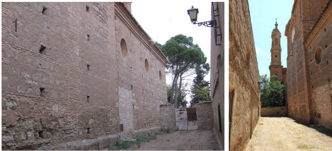
Ilustración 54. Estado actual de sus muros, a febrero de 2015. Fuente: Heraldo de Aragón
