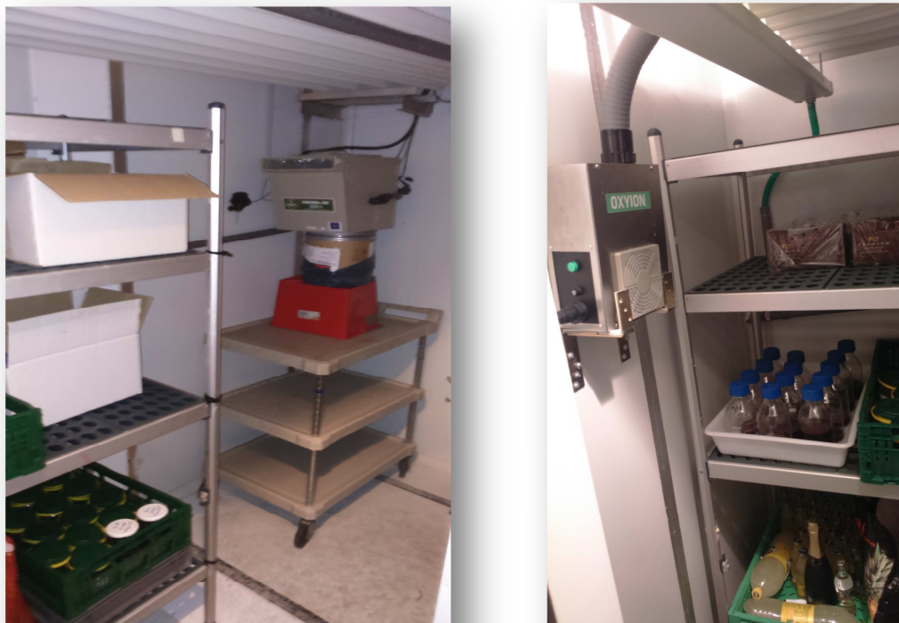
Figura 16. Cámara de refrigeración equipada con tecnología OXYION
