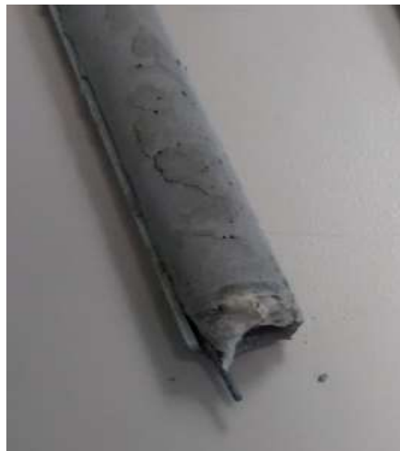
Figura III.2 Base y superficie defectuosa
