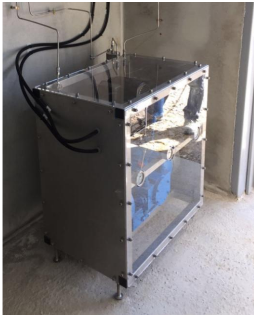
Figura 3.12: Compresor de hidrógeno.
