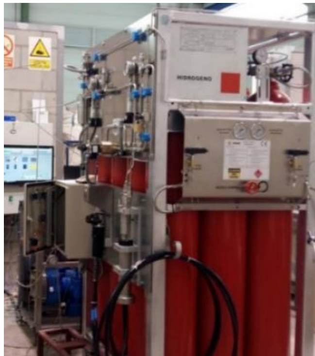
Figura 3.13: Rack de bombonas y sistemas de suministro.
