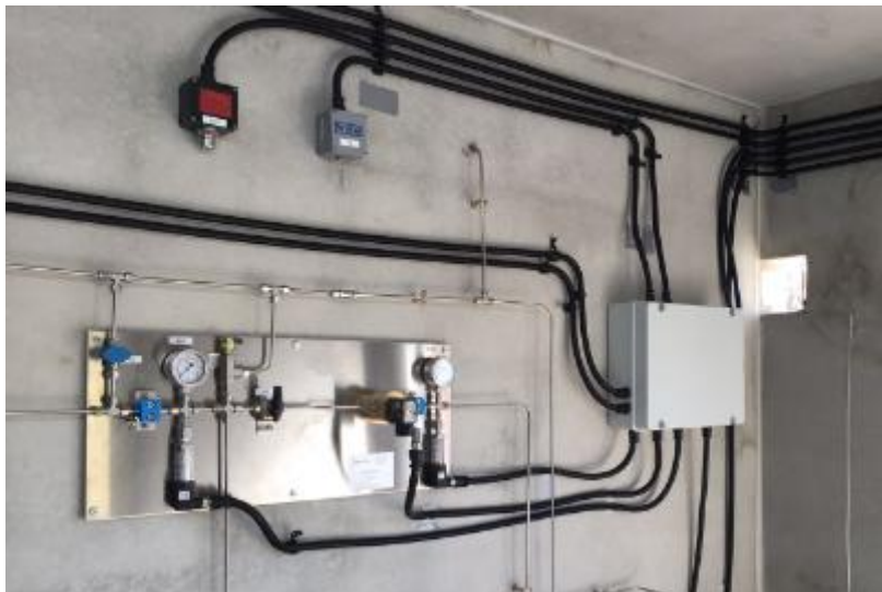
Figura 3.8: Panel de distribución de hidrógeno.
