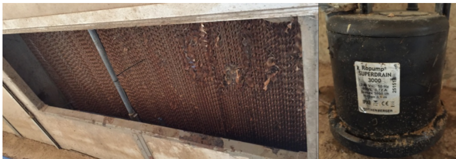
Figura 2.4 Panel humidificador y bomba correspondiente Fuente: Foto tomada explotación
