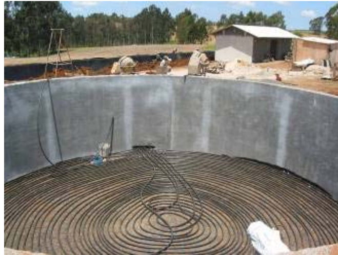
Figura 4.1 Tuberías para calentar el purín. Fuente: Producción Biogás Granja Marujo
