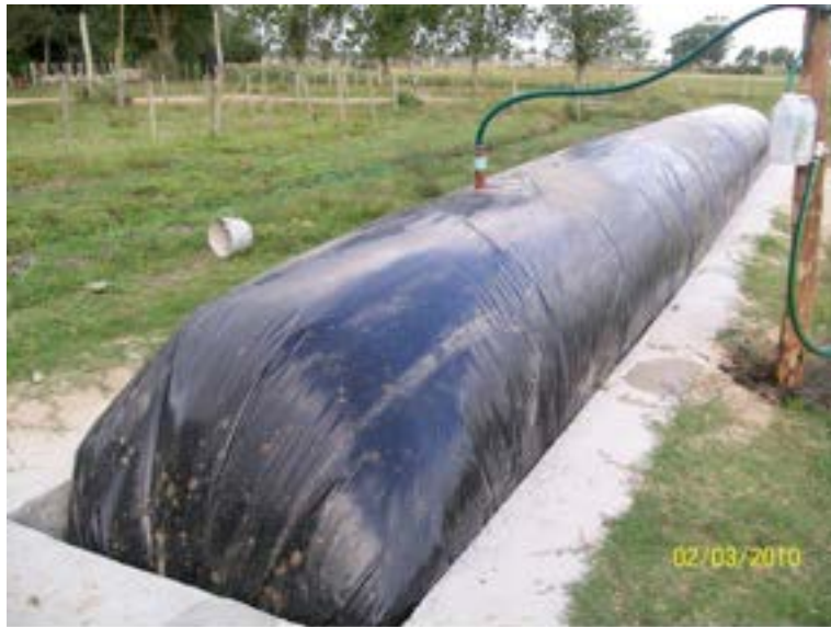
Figura 1.8 Digestor tipo Taiwán de estructura flexible. Fuente: Imágenes de google
