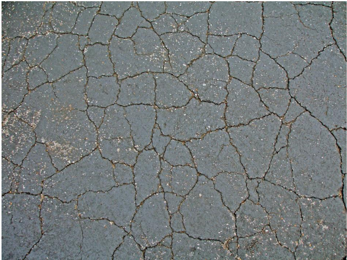
Figura 23. Elemento afectado por la relación álcali-sílice.
