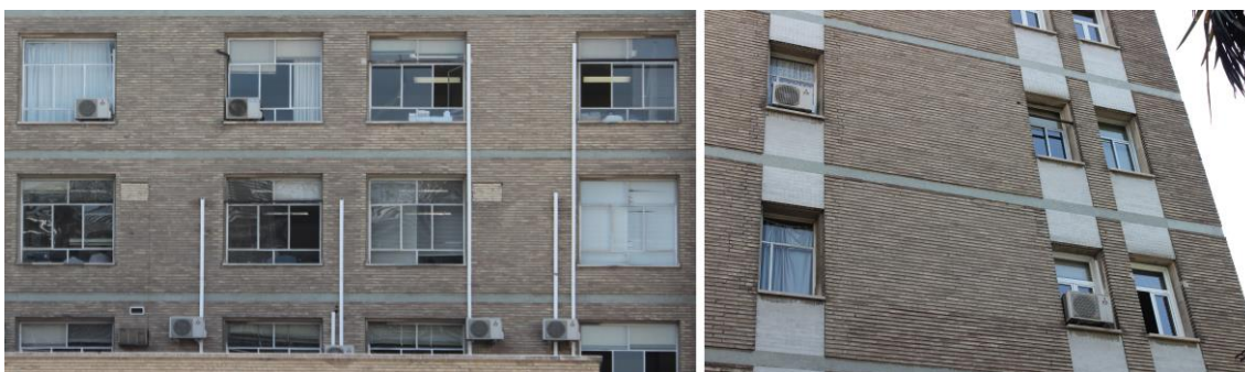
Fig. 49 Aparatos de aire acondicionado obstaculizando el acceso y dañando la imagen del edificio.
