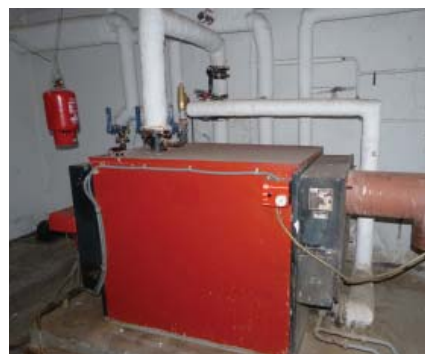
Fig. 42 Fotografía del cuarto de calderas
