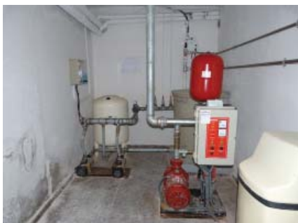
Fig. 41 Fotografía de la sala hidráulica
