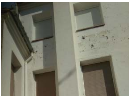
Fig. 55 Fotografía del deterioro de la fachada trasera
