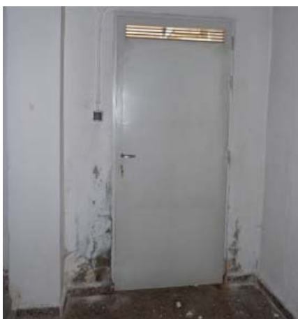
Fig. 56 Fotografía del deterioro de la planta semisótano
