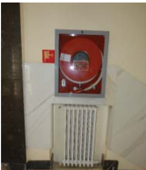
Fig. 45 Fotografía del inicio de escalera del tercer piso con la BIE.
