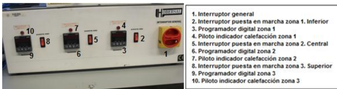
Figura A.8 Sistema de control de temperatura del horno eléctrico
