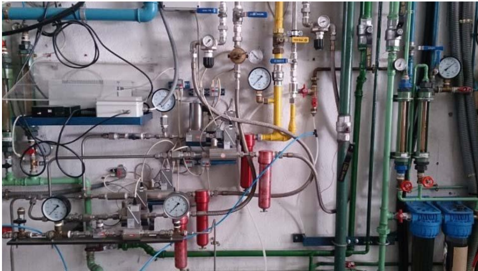
Figura 25: Líneas de gases.
