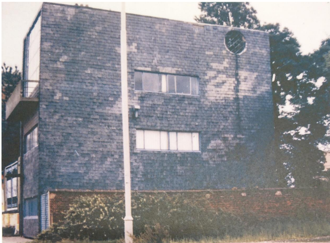
Fig. 83 Foto. Fachada lateral después de la instalación de teja negra de pizarra necesaria por las grietas y filtraciones que aparecieron. Después de 1945.
