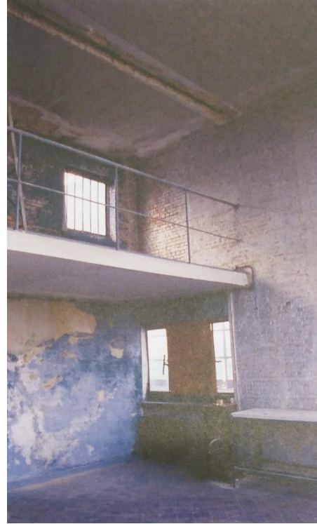
Fig. 90 El estado lamentable del yeso y la pintura del segundo piso. Patrick Robyn. Cerca de 1985.
