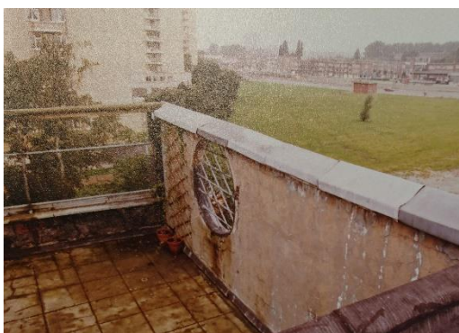
Fig. 87 Estado lamentable de la azotea de la casa Guiette tras el transcurso del tiempo.
