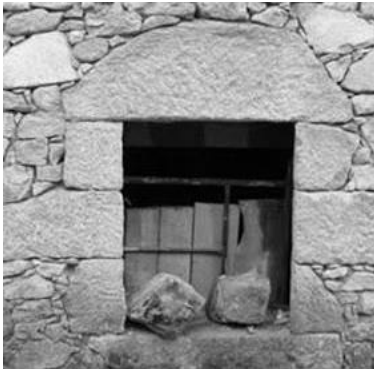
Fig. [7] - Hueco limitado por la necesidad de transmisión de cargas. Muro de carga de piedra con dintel arqueado. Fuente: territorioveton.blogspot.com
