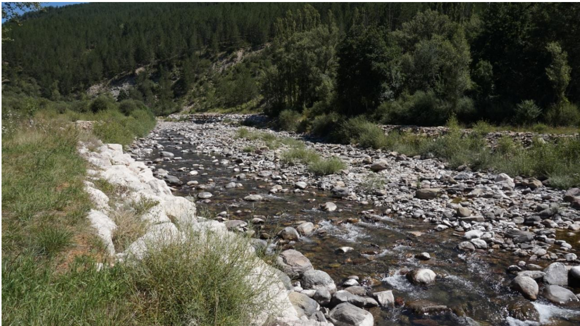
Foto 11. Dique de contención construido en la margen derecha del río Aragón a su paso por Castiello de Jaca.
