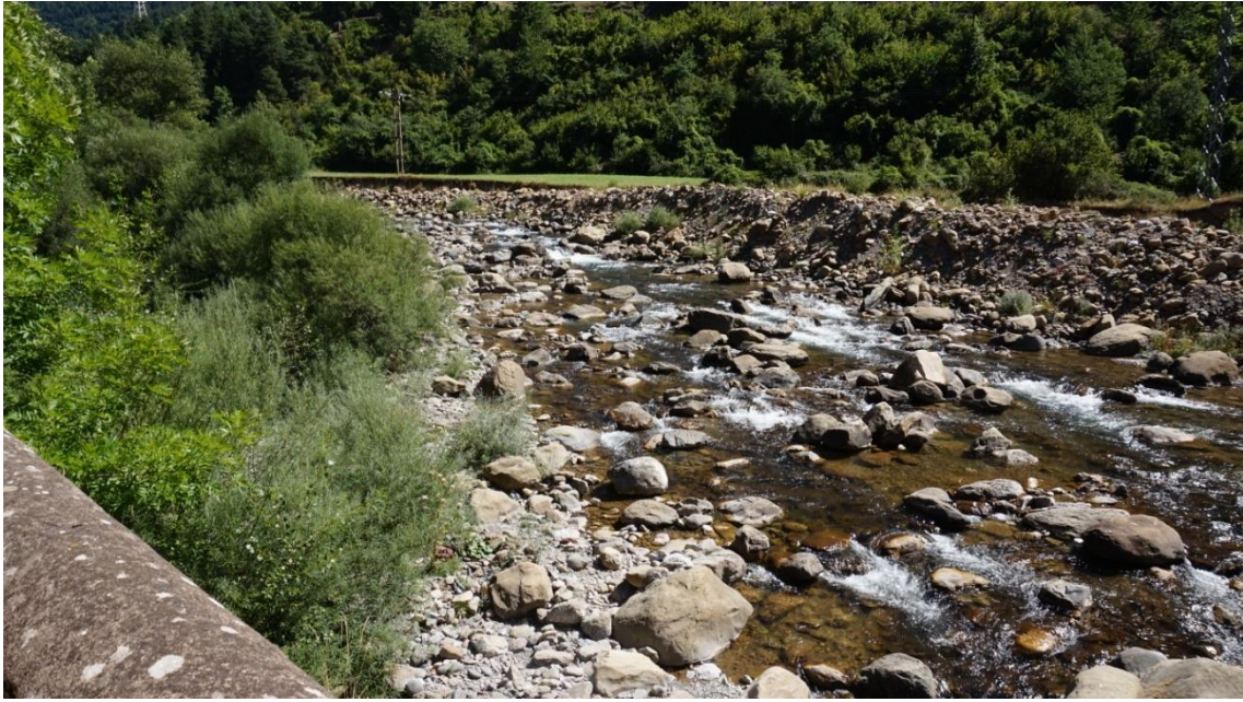
Foto 9: Dique de protección en la parte derecha del río Aragón a su paso por Canfranc
