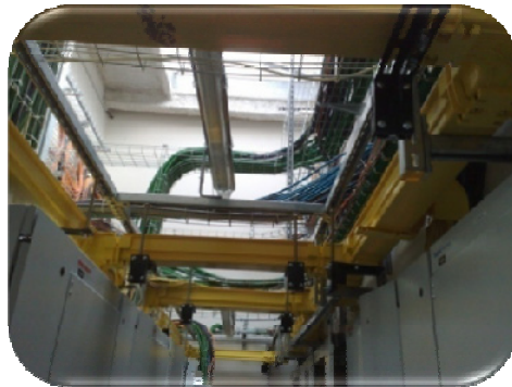
Figura 1.7 – Goulotte, cableado de fibra entre salas dentro de un emplazamiento
