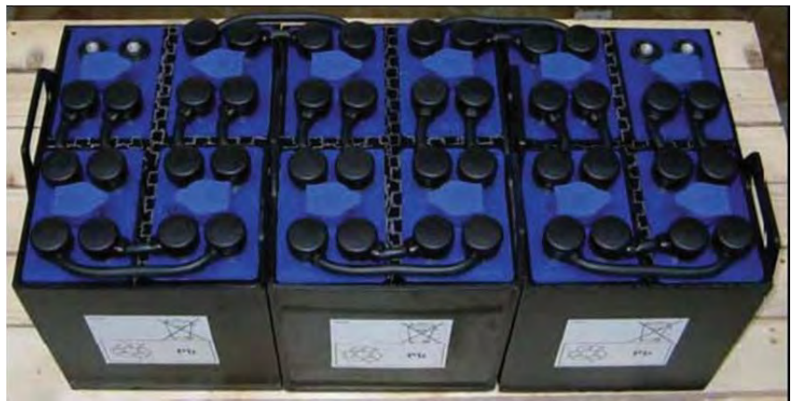
Figura A.21 – Sistema de Baterías
