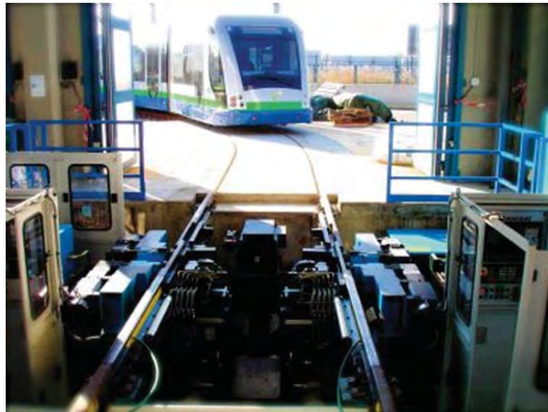
Figura A.32 - Fotografía torno de foso
