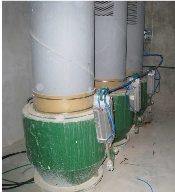
57. Válvulas de descarga [Eco-Ciudad Valdespartera S.A]
