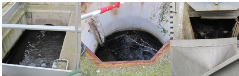
Figura 4.25: Imágenes de algunos puntos de muestreo. a) Salida decantador secundario (M3); b) Salida laguna 2 (M5); c) Salida centrífuga de fangos (M9)
