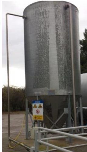
Figura 2.9: Tanque para el espesamiento de fangos
