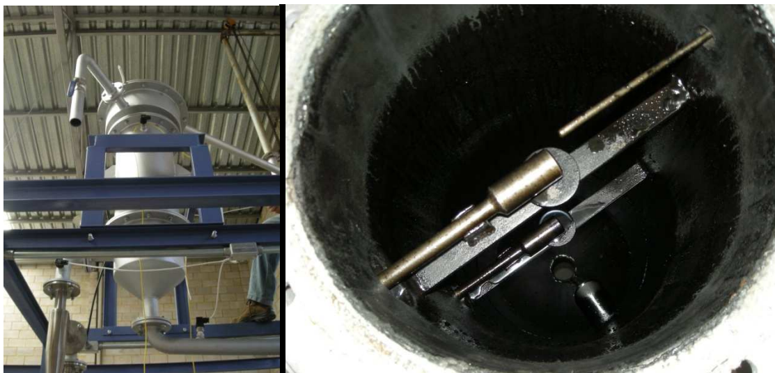
Figura 3.19. Torre lavadora o “scrubber”.
