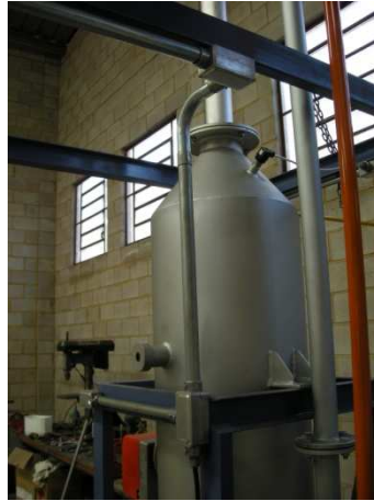
Figura 3.20. Cámara de combustión de gases.
