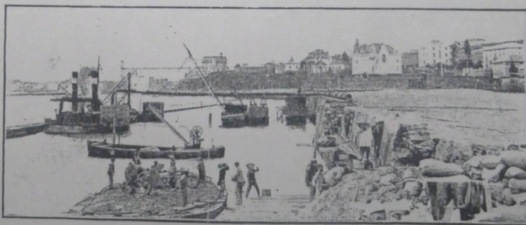
Estado actual de las importantes obras que se realizan en el puerto de Bilbao
