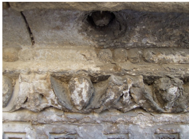
Figura 2. - Ejemplo del deterioro por acumulación de sales, con pérdida de volumen de la zona de labra. El detalle corresponde a la localización de la muestra UNSM-1 en la figura 3.
