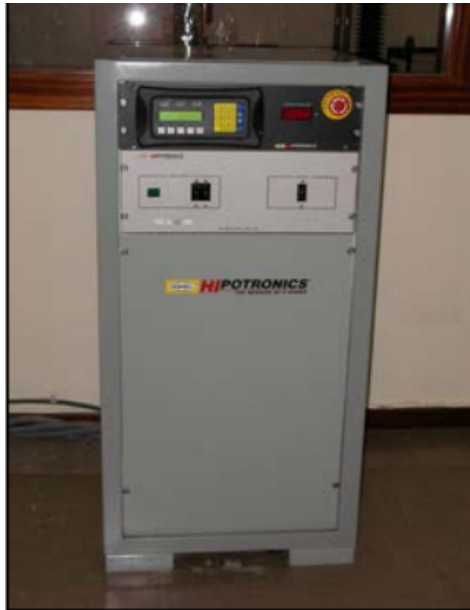
Fig. 19 Sistema de Control del transformador
