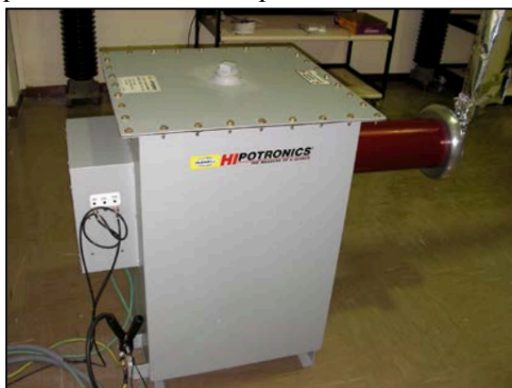
Fig. 18 Transformador de alta tensión
