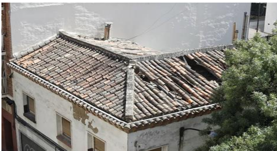
Figura 17. En esta imagen se ve la caída de parte del tejado en la Calle de la Luz en el barrio de Romareda el 3/5/18.
