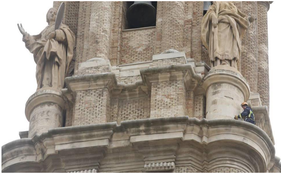
Figura 18. Esta otra imagen pertenece al suceso ocurrido el 13/2/17 en el que se varios cascotes del recubrimiento de la torre de la Seo, cayeron al suelo desde 40 metros de altura sin causar heridos, su origen se dijo que provenía de la humedad, el viento y las inclemencias del tiempo. Fuente: Heraldo de Aragón
