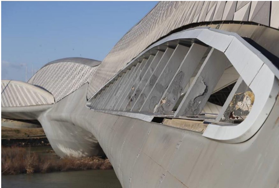
Figura 10. En la imagen se aprecia como fruto del cierzo salieron despedidas varias chapas del Pabellón Puente en la Almozara. Fuente: Heraldo de Aragón
