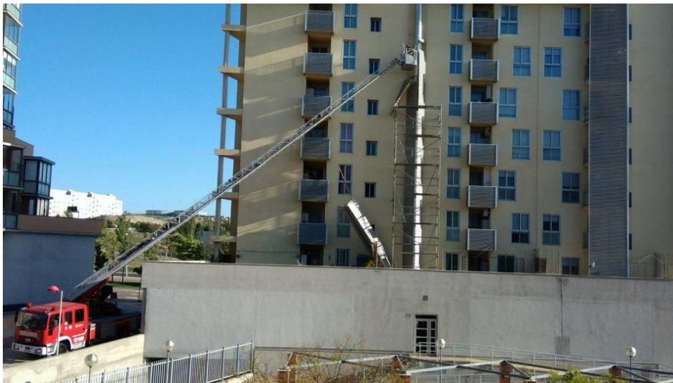
Figura 9. También se producen incidentes en edificios, por ejemplo, en la calle Una noche en la opera en el barrio de Valdespartera, se cayó parte del recubrimiento metálico del edificio. Fuente: Heraldo de Aragón
