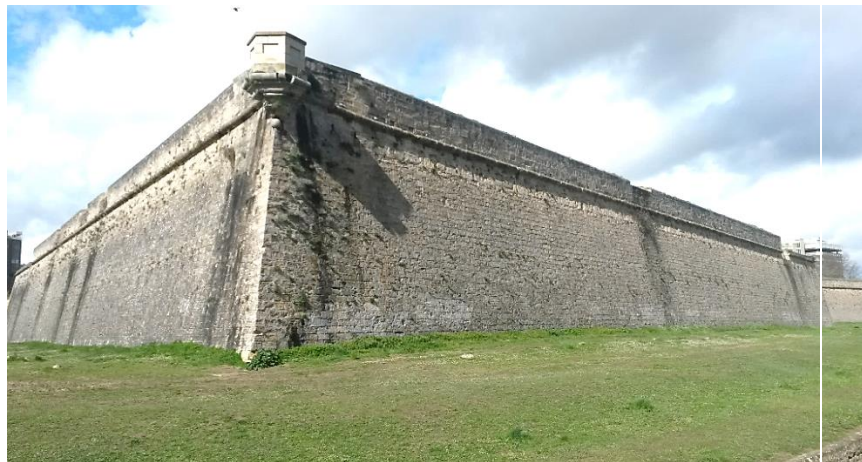
Figura 19. Arriba: vista aérea de la ciudadela de Pamplona en la actualidad. Fuente: Google Earth, [fecha de consulta 25-VII-2018]. Abajo: baluarte de Santa María desde el foso (foto del autor).
