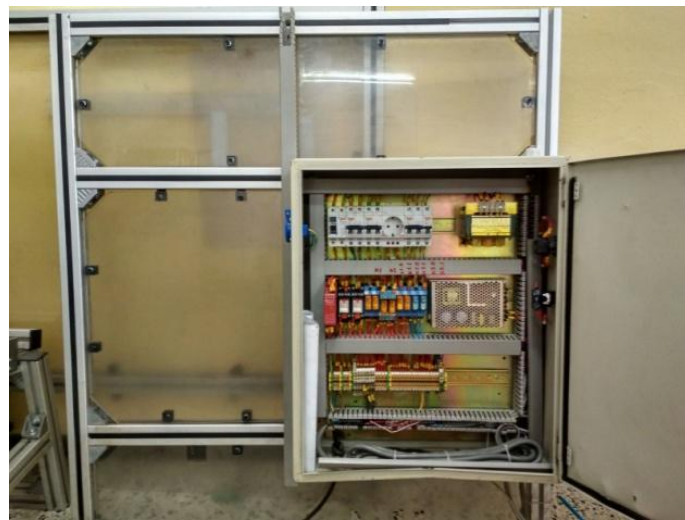
Cuadro eléctrico real
