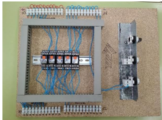
Cuadro eléctrico nuestro
