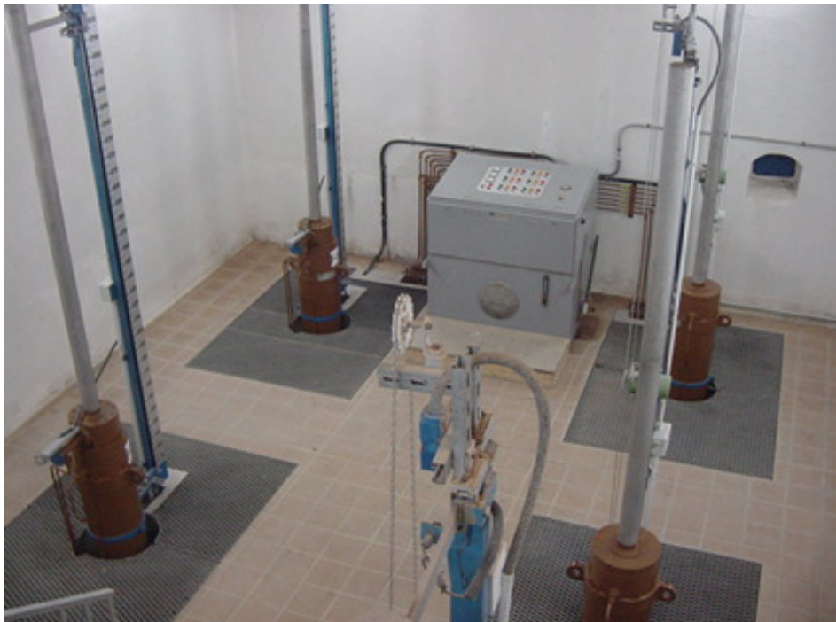
Figura 6: Cámara de maniobras del desagüe de fondo.
