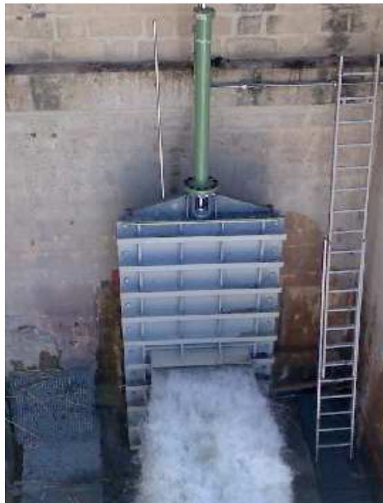
Figura 1: Compuerta Bureau en funcionamiento.
