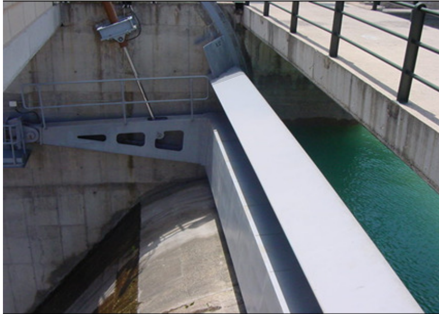
Figura 5: Detalle de la compuerta Taintor en el aliviadero.
