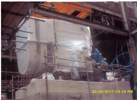
Figure 18 ID Fan Motor
