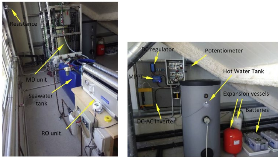
Figura 7. Detalle del sistema OI (izq.) y la cabina eléctrica, las baterías y el tanque de acumulación (dcha.) [16].
