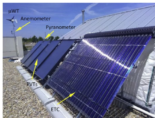
Figura 4. Disposición de los paneles solares de la planta piloto [16].
