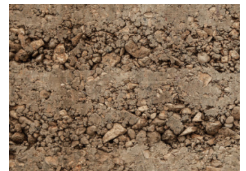
Fig 203, 204. Muro con y sin erosionar. 4 años de diferencia.
