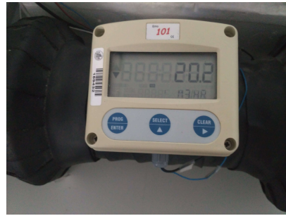
(3) Ventilador con caudalímetro.
