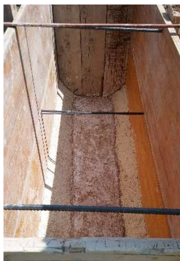
Fig 30 Costra de mortero de cal y cáñamo en interior de tapial. Fuente: Documentación gráfica de la empresa Elecnor
