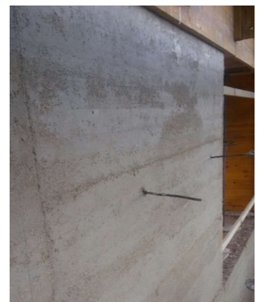
Fig 44 "Latiguillos" que se tienen que cortar a posteriori. Fuente: Documentación gráfica de la empresa Elecnor.
