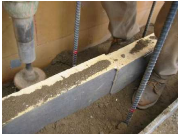
Fig 102 Puesta en obra con aislamiento y armaduras. Fuente: "Estudio Comparativo de las Técnicas Contemporáneas en Tierra" (Gatti, 2012)
