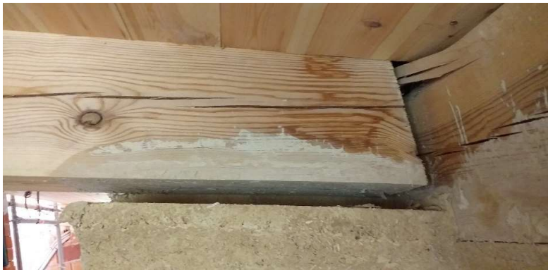
Fig 71 Separación del muro y la estructura de cubierta. Fuente: Documentación gráfica de la empresa Elecnor.
