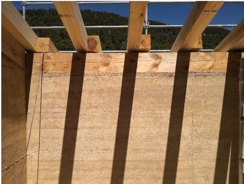
Fig 74 Muro de tapia desde interior. Fuente: Documentación gráfica de la empresa Elecnor
