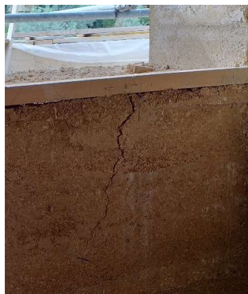
Fig 69 Grietas en las partes inferiores del muro. Fuente: Documentación gráfica de la empresa Elecnor.
