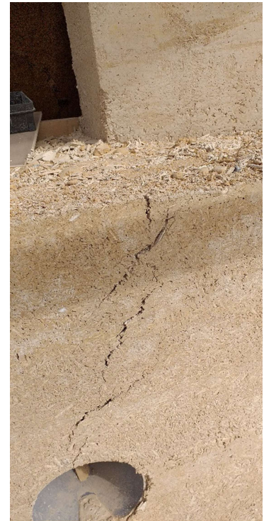
Fig 70 Grietas en las partes inferiores del muro. Fuente: Documentación gráfica de la empresa Elecnor.
