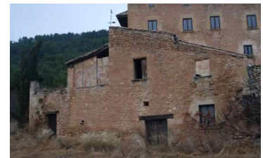
Fig 22 Edificaciones anexas en la fachada sur. . Fuente: Documentación gràfica de la empresa Elecnor.
