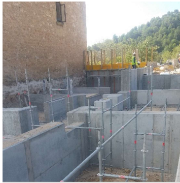
Fig 52 Muros de cimentación de hormigón armado. Fuente: Documentación gráfica de la empresa Elecnor.
