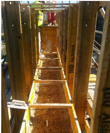
Fig 53 Esperas de unión del muro de cimentación con el tapial. Fuente: Documentación gráfica de la empresa Elecnor.
