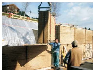
Fig 75 Puesta en obra de tapial prefabricado. Fuente: Paredes de tapial y su industrialización (M. Rauch, 2011)
