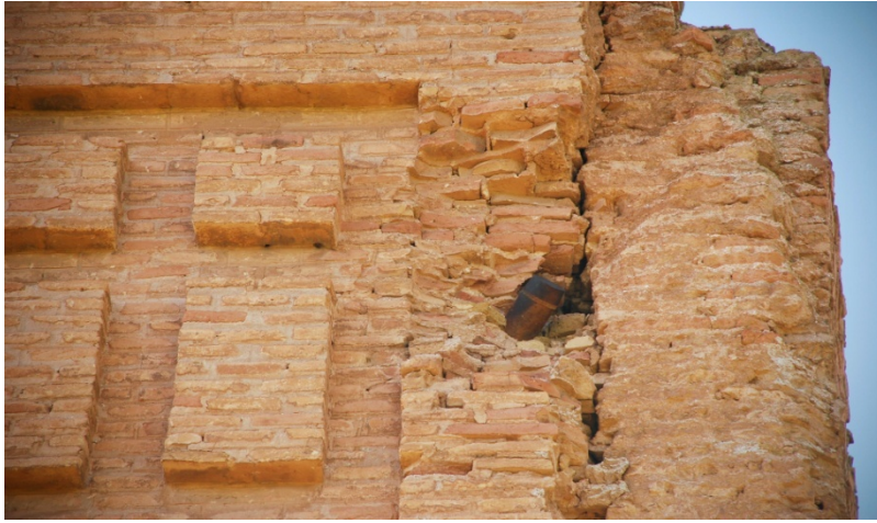
Proyectil anclado en una de las paredes de la Iglesia de San Agustín, en el pueblo Viejo de Belchite. (Antonio Becerrica Vidal, 2019)
