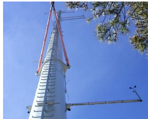
Figura 24: Torre tubular Fuente: Energías Renovables
