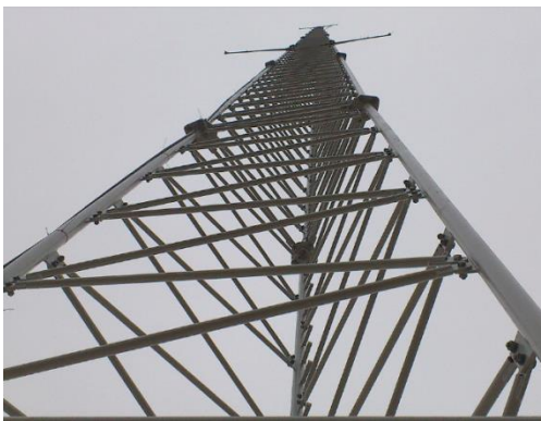
Figura 23: Torre celosía Fuente: Energías Renovables
