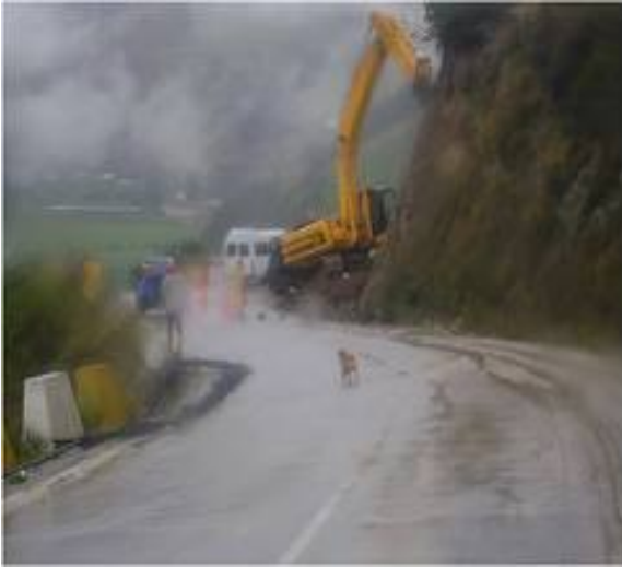
Fotografía 5.9 Problemas de Vialidad, Troncal 007 (Trasandina). Municipio Rangel. Estado Mérida. (2014)
