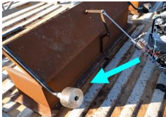
Ilustración 12: Contrapeso utilizado para la apertura por gravedad del exutorio
