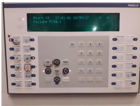
Ilustración 74 - Pantalla control Túnel
