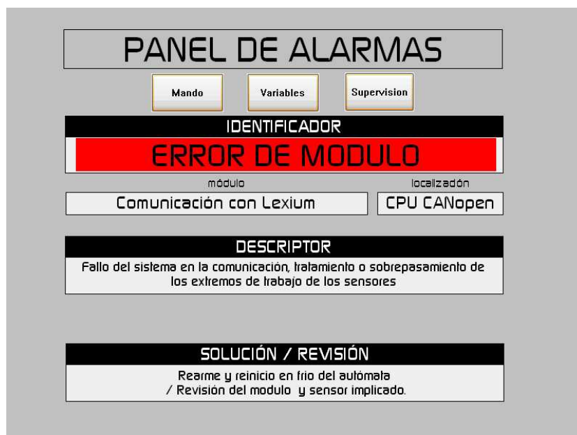
Vista de la pantalla de operador Alarmas indicando una alarma de error en la comunicación con LEXIUM
