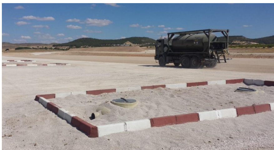
Figura 4. Depósitos de agua instalados en explanación logística en Chinchilla
