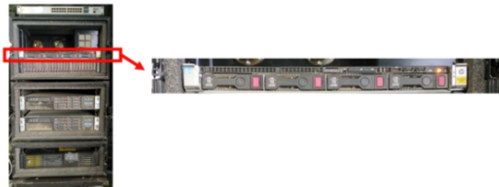
Ilustración 3. Servidor de Backup nodo SIMACET v5.
