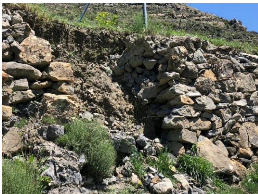
Figura 2: Detalle de un muro derrumbado en San Vicente de Munilla.
